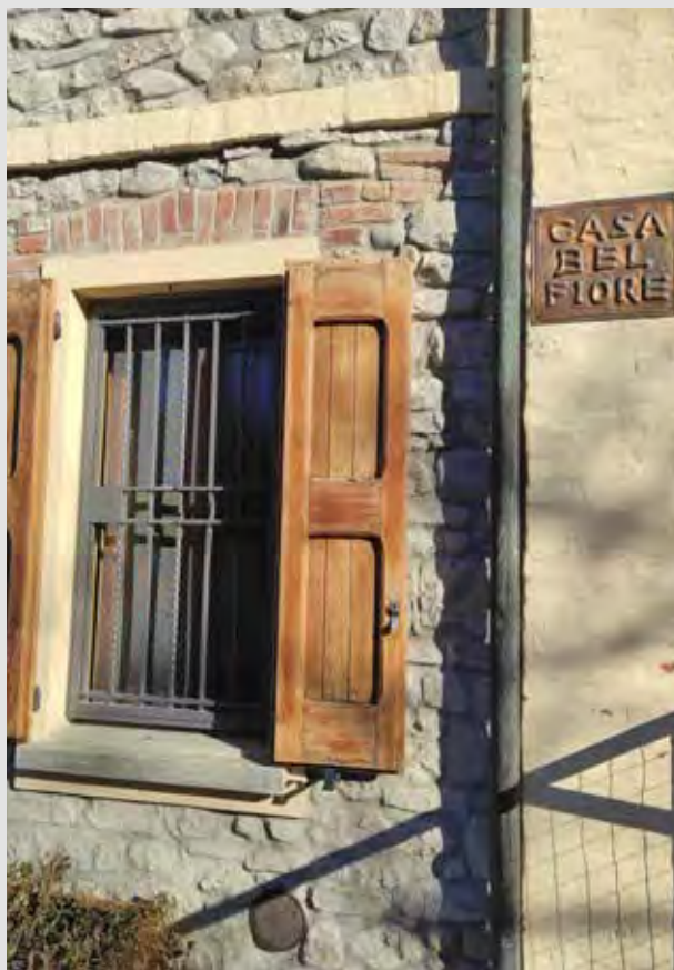
Inferriata di casa Belfiore danneggiata dalle bombe (foto di Nevio Preti).
